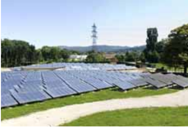
Fig. 3: solar thermal plant Wasserwerk Andritz
