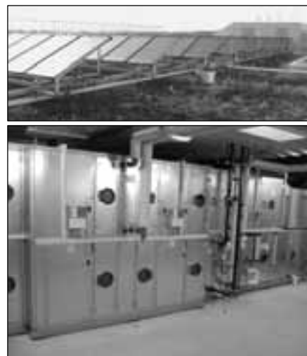
Fig. 1: Solar DEC-System in Ingolstadt
